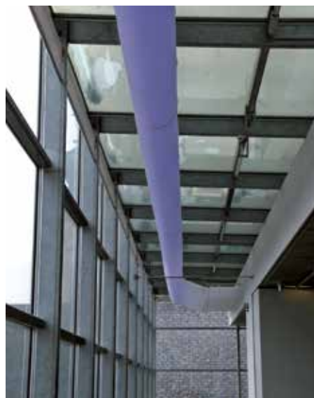
Auf allen Baustellen sind die Faktoren Zeit und Kosten von essenzieller Bedeutung – auch hier überzeugen textile Luftauslässe.
